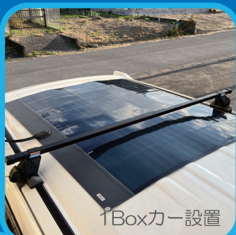
i-Boxカーダブル設置
